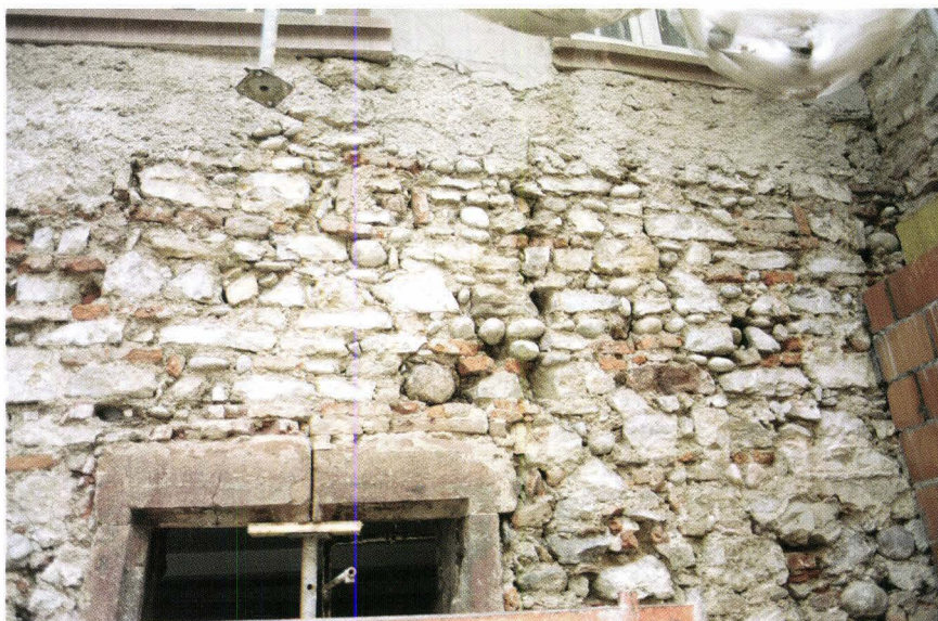
Abb. 48 Schneidergasse 28 / Pfeffergässlein 7 (D 2000/03). Pfeffergässlein 7, Hof-fassade. Der unterste Fassadenabschnitt (2. Hälfte des 14. Jahrhunderts) war bis anhin vom Waschhaustrakt des Hofflügelbaus verdeckt. Nach dem Entfernen der Verputze zeigt sich ein spätmittelalterliches Mauerwerk mit einem vermauerten (heute wieder reaktivierten) Fenster, welches nachträglich eingebaut worden war. – Foto: Basler Denkmalpflege.
