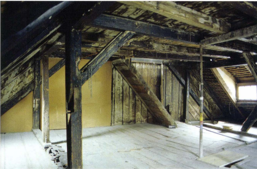
Abb. 57 Schneidergasse 28 / Pfeffergässlein 7 (D 2000/03). Pfeffergässlein 7, 1. Dachgeschoss. Beim Ständer des mittleren Binders auf der Hofseite wurden Strebe und Steigband nachträglich abgeschnitten, was in der Folge wegen mangelnder Stabilität zu Verformungen am First führte. Die runde Aussparung an Pfosten und Steigband diente als Auflager für die Kurbel des Warenaufzugs. – Foto: Basler Denkmalpflege.
