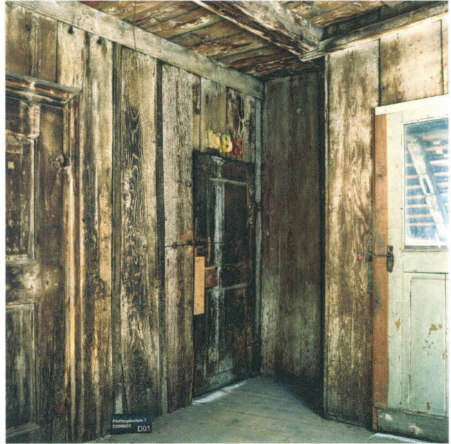
Abb. 25 Schneidergasse 28 / Pfeffergässlein 7 (D 2000/03). Pfeffergässlein 7, 1. DG. Das erste Dachgeschoss diente als Lagerraum. Bei der Unterteilung in Estriche für Mieter wurden alte Zimmertüren verwendet. – Foto: Ruedi Walti.
