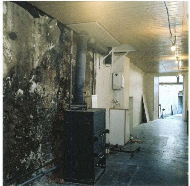
Abb. 5 Schneidergasse 28 / Pfeffergässlein 7 (D 2000/03). Schneidergasse 28, Erdgeschoss. Laden mit Blick in den Hinterhof. An der russgeschwärzten Brandmauer der Ofen, von dem der Brand ausging. – Foto: Ruedi Walti.
