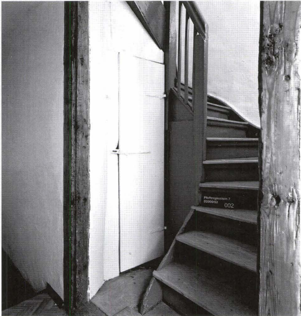
Abb. 19 Schneidergasse 28 / Pfeffergässlein 7 (D 2000/03). Pfeffergässlein 7, EG. Das in den 1. Stock führende Treppenhaus liegt auf der Nachbarparzelle. Die Pfosten im Vordergrund flankieren den Durchgang zum Nachbarhaus. – Foto: Ruedi Walti.
