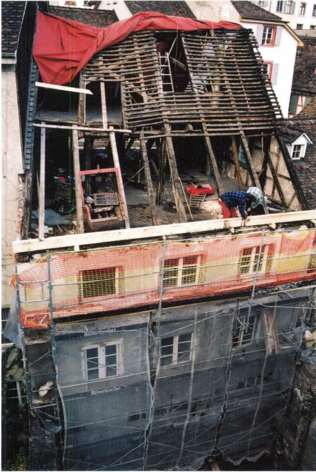
Abb. 59 Schneidergasse 28 / Pfeffergässlein 7 (D 2000/03). Pfeffergässlein 7. Aufgrund der langwierigen Baumassnahmen konnte das Dach eingehend untersucht werden. Der Blick vom Vorderhaus zeigt die Zimmerleute beim Richten der neuen Fusschwelle für das zusätzliche Tragwerk. Deutlich sichtbar sind die originale Ziegellattung sowie die Fachwerkwand des Nordgiebels. – Foto: Basler Denkmalpflege.
