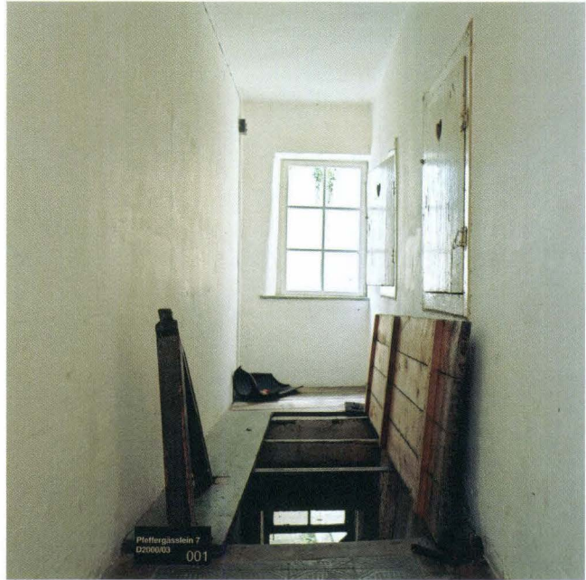
Abb. 18 Schneidergasse 28 / Pfeffergässlein 7 (D 2000/03). Pfeffergässlein 7, EG. An der Stelle des Fensters am Ende des Eingangsflurs war früher der Zugang zur Verbindungslaube. Die Öffnung für die Treppe in den Hof hinunter kann deshalb mit einem Falldeckel geschlossen werden. – Foto: Ruedi Walti.
