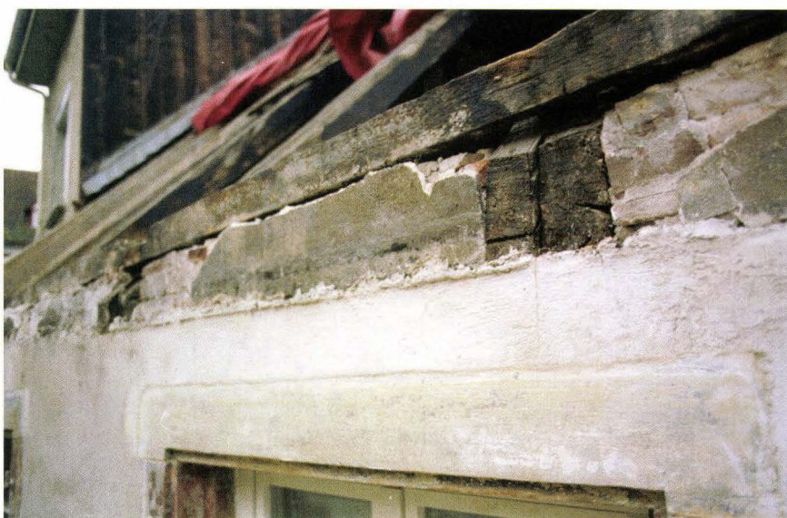
Abb. 62 Schneidergasse 28 / Pfeffergässlein 7 (D 2000/03). Pfeffergässlein 7, Dachfuss auf der Hofseite. Nach dem Entfernen des Dachhimmels zeigte sich, dass Sparren und Dachbalken fassadenbündig abgesägt waren. Ursprünglich liefen die mit den Balken verblatteten Sparren weiter und bildeten den Dachüberstand. – Foto: Basler Denkmalpflege.
