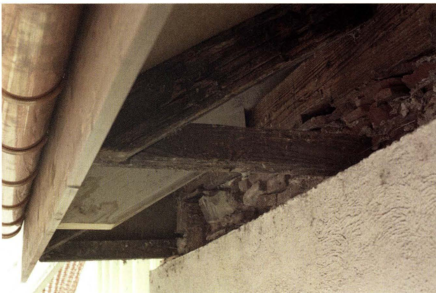
Abb. 9 Gerbergasse 63 (2005/725). Dachfussausbildung an der Gerbergasse. Die später angebrachten Aufschieblinge liegen auf einem zum Dachwerk sekundären Schwellbalken auf, welcher in einer Aufmauerung der Aussenwand eingebettet ist. In der Verlängerung der Dachbalken wurden ausserdem kurze Bälkchen angesetzt, welche mit den Enden der Aufschieblinge abschliessen und die Tragkonstruktion für den Dachhimmel bilden. – Foto: Basler Denkmalpflege.
