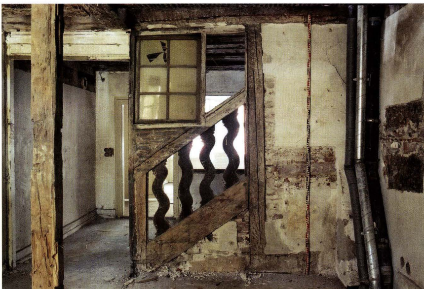
Abb. 13 Rebgasse 13 (2005/23). Blick auf die östliche Zwischenwand im 1. Obergeschoss mit dem Rest einer Treppenanlage zum 2. OG. Rechts die nordseitige Brandmauer zu Haus Nr. 11. Das Fragment der Treppe wurde während der Untersuchung freigelegt. Es stammt aus dem Umbau von 1721. Die vier Brettbaluster sind bloss ausgesägt. Der Abbruch der Treppenanlage und die teilweise Schliessung der Wand erfolgte in der Mitte des 19. Jahrhunderts. – Foto: Basler Denkmalpflege.
