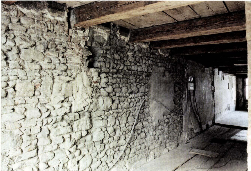
Abb. 3 Spalenberg 29 (2004/478). Die Westbrandmauer im 3. Obergeschoss. Blick von Süden in Richtung Spalenberg. Die Brandmauer zum Nachbarhaus Nr. 31 ist vor Untersuchungsbeginn mit einer Schicht Zementmörtel zugedeckt worden. Das Mauerbild ist zwar erkennbar, doch der Zustand ist für die Dokumentation ungeeignet. Im Hintergrund sind belassene Verputzflächen. Dort wurden nur punktuell Sondierungen vorgenommen. – Foto: Basler Denkmalpflege.
