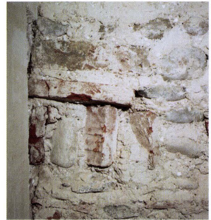
Abb. 14 Lindenbergs 12 (2004/339). 1. OG, lindenbergsseitiger Gebäudeabschnitt. Das Bälkchen des Baugerüsts in der nördlichen Gebäudeecke von Haus C wurde in diagonaler Ausrichtung eingemauert und mit Ziegelsteinen verkeilt. – Foto: Basler Denkmalpflege.
