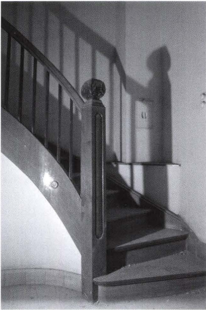
Abb. 2 Rheinsprung 20 (2005/13). Bestandsaufnahme vor dem Umbau 1986. Ehem. Dienstbotentreppe im südlichen Hausteil. Treppenantritt mit dekorativem Antrittspfosten – Foto: Basler Denkmalpflege.
