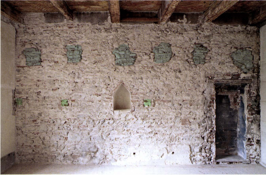
Abb. 13 Lindenbergs 12 (2004/339). 1. OG, lindenbergsseitiger Gebäudeabschnitt. Die lindenbergsseitige Mauer des früheren Hauses C. Die dem Gebäudeinnern zugewandte Mauernische ist im Mauerwerk original angelegt. Auf gleicher Höhe liegt eine Reihe von Bälkchennegativen des Baugerüsts (grün). Die Deckenbalken lagen ursprünglich weiter unten; die frühere Deckenhöhe ist an den vermauerten Balkenkopfausbrüchen ablesbar. – Foto Basler Denkmalpflege.
