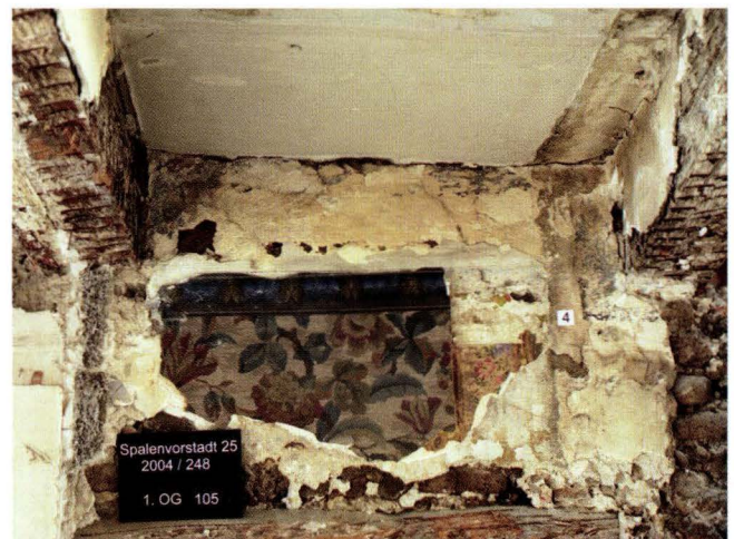
Abb. 31 Spalenvorstadt 25 (2004/248). 1. Obergeschoss, Hausmitte, Blick an die Westbrandmauer. Tapetenreste des 19. Jahrhunderts (kleines Stück rechts) und des frühen 20. Jahrhunderts (grosses Stück mit Bordüre). – Foto: Basler Denkmalpflege, Matthias Merki.
