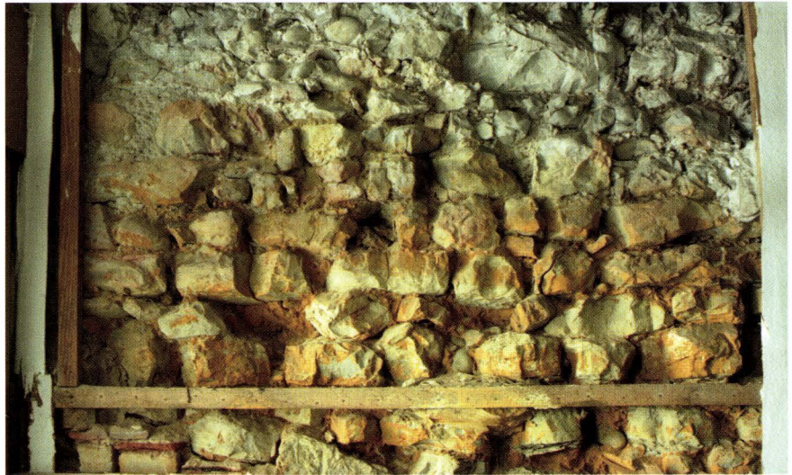
Abb. 4 Spalenvorstadt 25 (2004/248). Die originale Ostbrandmauer im Erdgeschoss beim Hauseingang. Risse und Abplatzungen der Steine und verfärbter Mörtel zeugen von einem frühen Brand, der an der jüngeren Westbrandmauer nicht nachzuweisen ist. Die ockerfarbige Verfärbung im untern Bereich rührt von einer Verschimmelung hinter der modernen Wandverkleidung her. – Foto: Basler Denkmalpflege, Stephan Tramèr.
