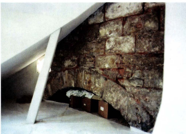
Abb. 14 Rheinsprung 8 und 10, Stützmauer der Martinskirche (2003/346 und 2003/443). Blick von Rheinsprung 8 an den westlichen Gewölbebogen des Erkers. Um die Fugen zwischen den Sandsteinen zeichnerisch erfassen zu können, musste die gesamte Oberfläche von Ausflickungen und Farbschichten befreit werden. Die Fugen sind mit einem mit Ziegelmehl vermischten, rötlich-sandigen und sehr feinkieseligen Mörtel sekundär ausgestrichen und stellenweise auskorrigiert. Der originale Fugenmörtel konnte nicht erfasst werden. – Foto: Basler Denkmalpflege.
