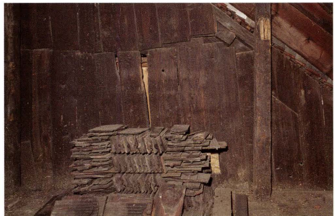
Abb. 14 Gerbergasse 63 (2005/725). Blick an die südliche Scheidewand im 1. Dachgeschoss. Verbretterte, ehemals gegen aussen gerichtete Giebelwand des Hauses Gerbergasse 65. Sichtbar ist die Dachlinie, der Balkenkopf der Mittelpfette und die am Kehlbalken zusammengesetzte Verbretterung. – Foto: Basler Denkmalpflege.
