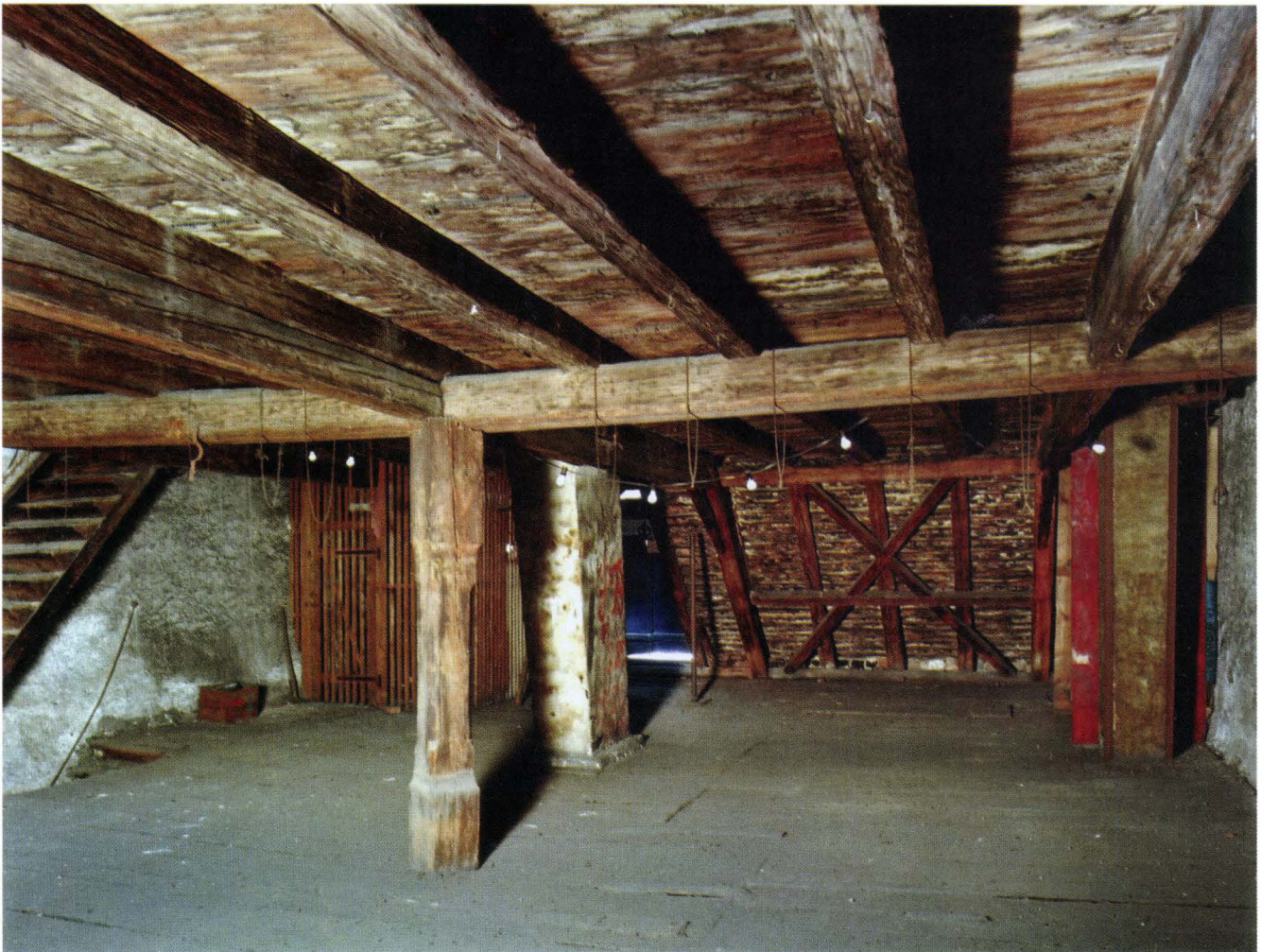
Abb. 5 St. Alban-Vorstadt 35 (2005/663). Liegender Dachstuhl von 1579. Im unteren Geschoss werden die Kehlbalken durch einen Mittelunterzug unterstützt. Der Kopf der über Eck gestellten Säule umgreift den Unterzug nicht (wie üblich), da die eingestemmten Spannriegel des mittleren Binders dies verhindern. Im Hintergrund ist die rheinseitige Dachfläche mit dem Anderskreuz, das zwischen Fuss- und Mittelfette eingespannt ist, zu erkennen. – Foto: Basler Denkmalpflege.
