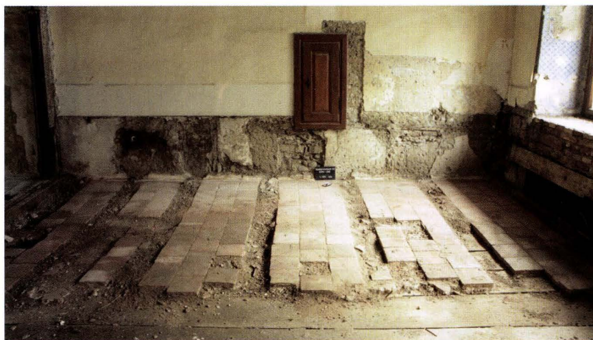
Abb. 13 Spalenvorstadt 25 (2004/248). Westbrandmauer, 1. Obergeschoss, strassenseitiger Raum. Nach Entfernen des oberen Holzbodens kam beim Umbau ein alter Tonplattenboden zum Vorschein. Die Dielen lagen auf Kanthölzern im Bereich der fehlenden Plattenreihen. – Foto: Basler Denkmalpflege, Matthias Merki.
