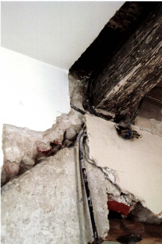
Abb. 18 Lindenberg 12 (2004/339). 2. OG, lindenbergsseitiger Gebäudeabschnitt. Auf die Giebelmuerkrone von Haus A gesetzter Mauerzwickel. In den Zwickel wurde der rückseitige Unterzug für die Dachbalken des Hauses von 1501 eingemauert. – Foto: Basler Denkmalpflege.
