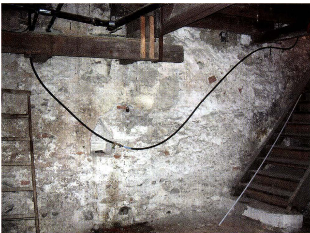
Abb. 17 Rebgasse 13 (2005/23). Die nordseitige Kellermauer mit spitzgiebliger Nische vor den Freilegungsarbeiten. Der Keller ist durch eine Unterfangung der Fundamentmauern geschaffen worden. Die Treppe führt vom erst 1872 erstellten Treppenhaus in den Kellerraum. Die Unterkante der unterfangenen Nordbrandmauer liegt in der Mitte zwischen dem oberen Nischenabschluss und der Unterkante der Deckenbalken. – Foto: Basler Denkmalpflege.
