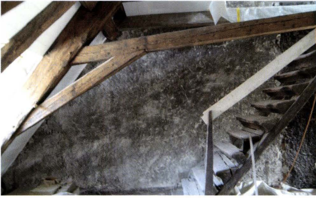
Abb. 21 Spalenvorstadt 25 (2004/248). 1. Dachgeschoss, Blick gegen die Ostbrandmauer. Oben im Vordergrund ein Balken des zweiteiligen Spannriegels. Dahinter an der Brandmauer die alte Blocktreppe, welche 2005 in situ belassen und restauriert worden ist. – Foto: Basler Denkmalpflege, Matthias Aebersold.
