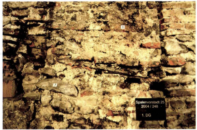
Abb. 9 Spalenvorstadt 25 (2004/248). 1. Dachgeschoss, Westbrandmauer. Der Ausschnitt zeigt Reste von Holzschindeln des schwach geneigten ersten Daches. Darüber erhebt sich ein zahnartiger Aufsatz, der ebenfalls zum ältesten Teil der Brandmauer gehört. Diese wurde vermutlich im späten 14. Jahrhundert errichtet (nach dem Erdbeben von 1356). – Foto: Basler Denkmalpflege, Hans Ritzmann.
