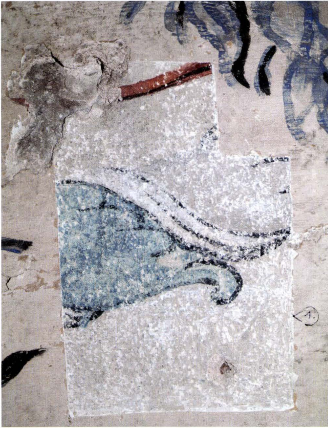
Abb. 32 Lindenberg 12 (2004/339). 1. OG, rheinseitiger Gebäudeabschnitt (Stube). Freigelegter Ausschnitt der ältesten, polychromen Malerei an der massiven Binnenwand. Teil eines mit Band umwickelten, girlandenförmigen Laubkranzes. – Foto: Basler Denkmalpflege.
