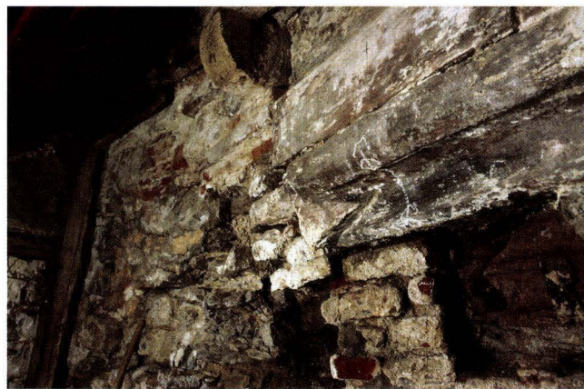
Abb. 22 Rheinsprung 8 und 10, Stützmauer der Martinskirche (2003/346 und 2003/443). Blick auf den Abschlussstein des Gurtgesimses mit der in die Hohlkehle greifende Keilform. Deutlich wird, wie das durch Ausflickung untermauerte Gurtgesims in der Stützmauer keine Fortsetzung findet. – Foto: Basler Denkmalpflege (1995).
