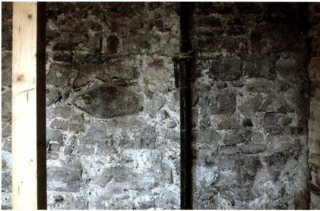
Abb. 8 Rheinsprung 8 und 10, Stützmauer der Martinskirche (2003/346 und 2003/443). 1. Obergeschoss von Rheinsprung 10. Blick auf die Stützmauer nach dem Ausbau der beschädigten Täferbretter. Die Sondierflächen an der Stützmauer zeigen mehrheitlich Kalkbruchsteine von mittlerer Grösse. Mörtel und Schichtung der Steine stimmen an den Sondierstellen überein. Es sind wenige Backsteine und vereinzelt Wackensteine beigegefügt. Der hellgraue Mörtel ist grobkiesig. Auf der Maueroberfläche kleben Reste eines jüngeren Mörtels, mit dem die Mauerfugen satt ausgestrichen sind. Die Steine bilden eine homogene Maueroberfläche. Gegen den Dachansatz nimmt der Mauerquerschnitt geringfügig ab. – Foto: Basler Denkmalpflege (1995).
