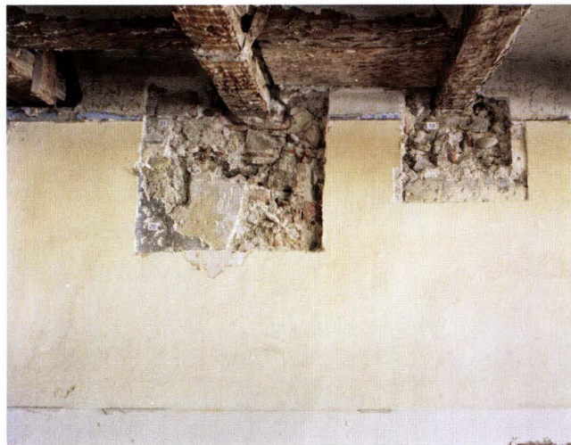
Abb. 12 Spalenvorstadt 25 (2004/248). Westbrandmauer, 1. Obergeschoss, strassenseitiger Raum. Im kleinen freigelegten Feld unter dem Deckenbalken ist die Oberkante des originalen Glattputzes mit einem (sekundären?) Malrest erkennbar. Die beiden Putzfragmente im linken Sondierungsfenster sind sekundär. Zum hellen gehört das Grauband mit schwarzem Filet, von dem ein kleiner Rest links oben zu sehen ist. An und zwischen den Deckenbalken sind noch Reste der Vergipsung aus dem späten 17. oder frühen 18. Jahrhundert sichtbar (siehe auch Abb. 31). – Foto: Basler Denkmalpflege, Matthias Merki.
