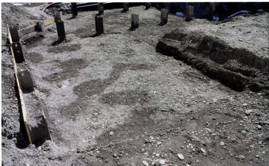
Abb. 8 Lichtstrasse 35, Novartis Bau WSJ-200, 2004/18. In der natürlichen Kiesoberfläche des Perimeters für den Campanile zeichnen sich zahlreiche neuzeitliche Befunde ab. – Foto: Philippe Wernher.
