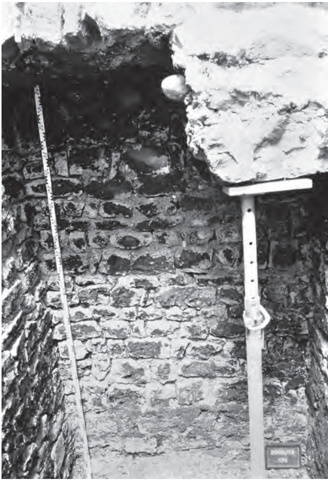
Abb. 2 Schnabelgasse 6. Die nördliche Latrinenmauer aus regelmässig geschichteten Kalkbruchsteinen, die mit einem grobkörnigen Mörtel vermauert wurden. Der Mörtel ist vom sauren Latrineninhalt stark angegriffen. – Foto: Catrin Glaser.
