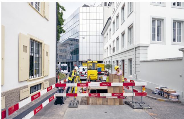
ABB. 4 Da während der Bauarbeiten die Zufahrt zu den anliegenden Innenhöfen stets gewährleistet sein musste, waren in der schmalen Gasse aufwendige Überdeckungen des 4 m tiefen Kanalisationsgrabens nötig. Foto: Philippe Saurbeck.
